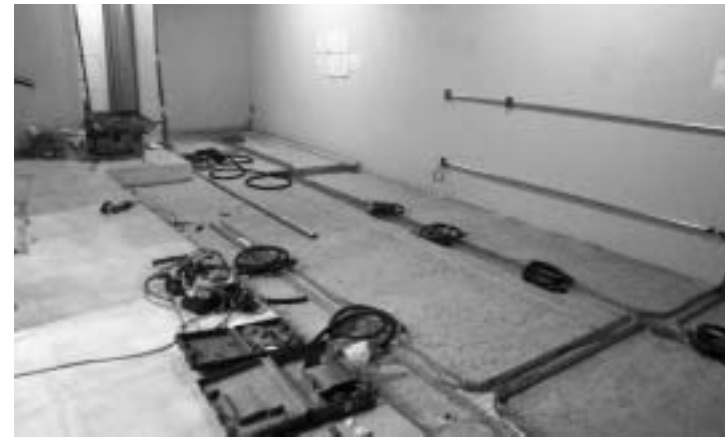
Cabos na parte interna antes da chegada dos equipamentos
